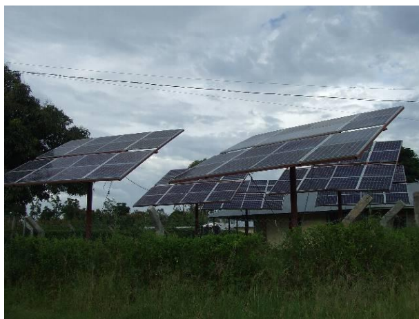
病院内のソーラーパネル
